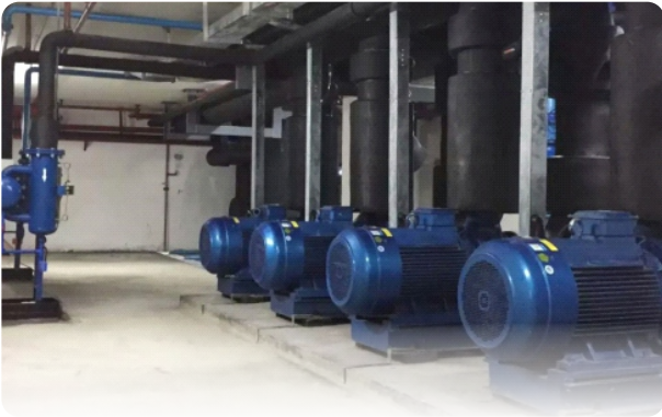
工程项目: 佛山樵岭国际商业中心2栋 工程地址: 广东省/佛山市 安装规模: 4200冷吨
