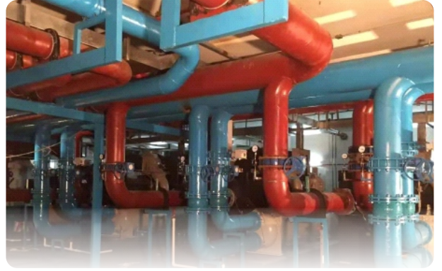
工程项目: 佛山富弘广场中央空调 工程地址: 广东省/佛山市 安装规模: 4300冷吨
